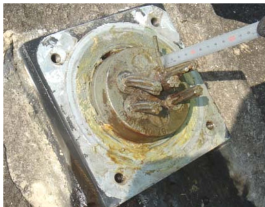
余長が短いさびタイプアンカー (アタッチメントが設置できないアンカー)
