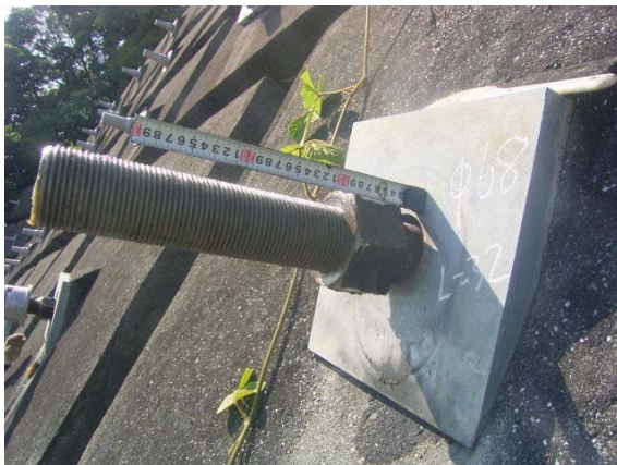
アンカーヘッドの浮き出し
