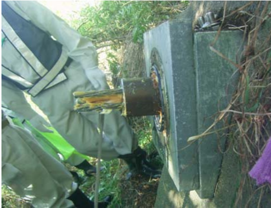
アンカープレートの顕著なズレ (PC 鋼より線へせん断方向への負荷の可能性)
