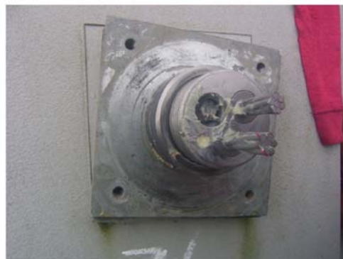
頭部状況(PC 鋼より線の引き込まれ)
