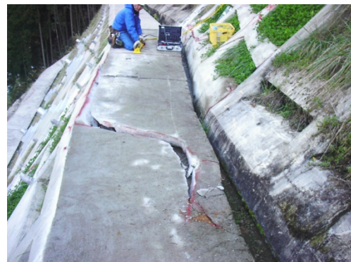
のり面のクラック
