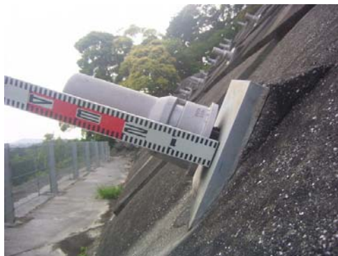
アンカーキャップの浮き出し
