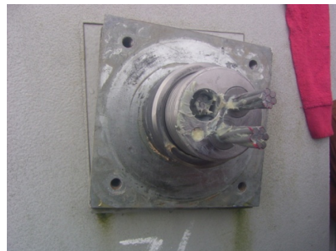
PC 鋼より線の引き込まれと アンカープレートのずれ
