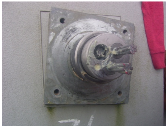
アンカープレートのズレと PC 鋼より線の引き込まれ
