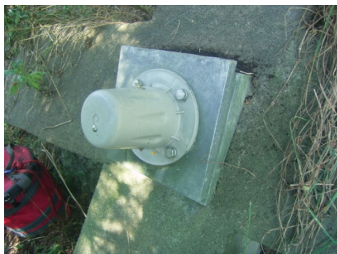
アンカープレートのずれ
