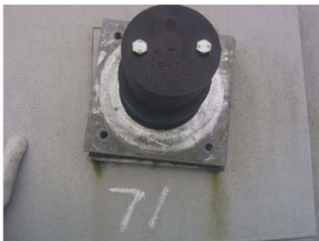
頭部状況(アンカープレートの変位)
